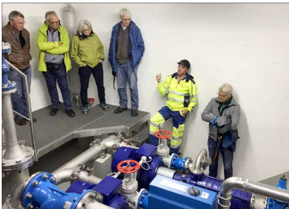
Brunnenmeister Wendelin Böni (2. v. rechts) erklärt das Innere des Wasserreservoirs Mennweg.
