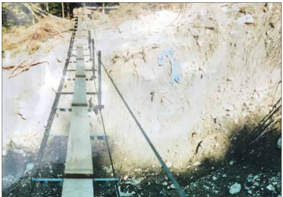
Meisterleistung: Hängesteig nach dem Erdrutsch im Jahr 1993.
