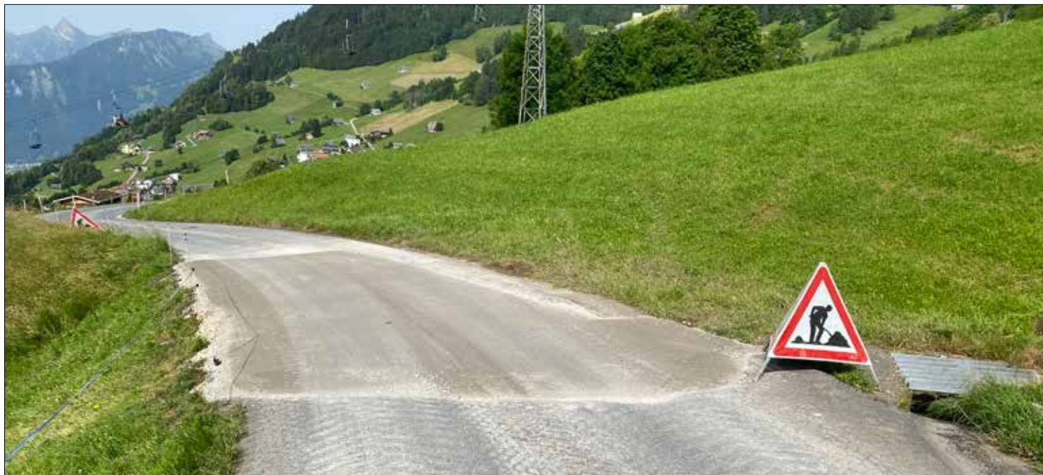
Ende Juni wurde die Hinterbergstrasse im Bereich Käsern unterspült, sodass eine sofortige, provisorische Reparatur nötig wurde.
