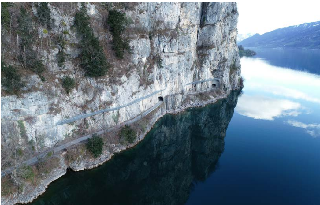
Für eine mögliche Sanierung der Tunnels an der Betliserstrasse wird ein Vorprojekt erarbeitet.
