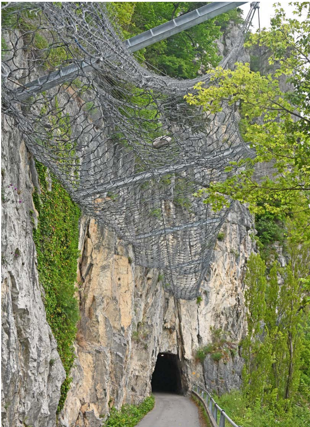
Das beschädigte Steinschlag-Schutznetz am Morgen nach dem Ereignis
